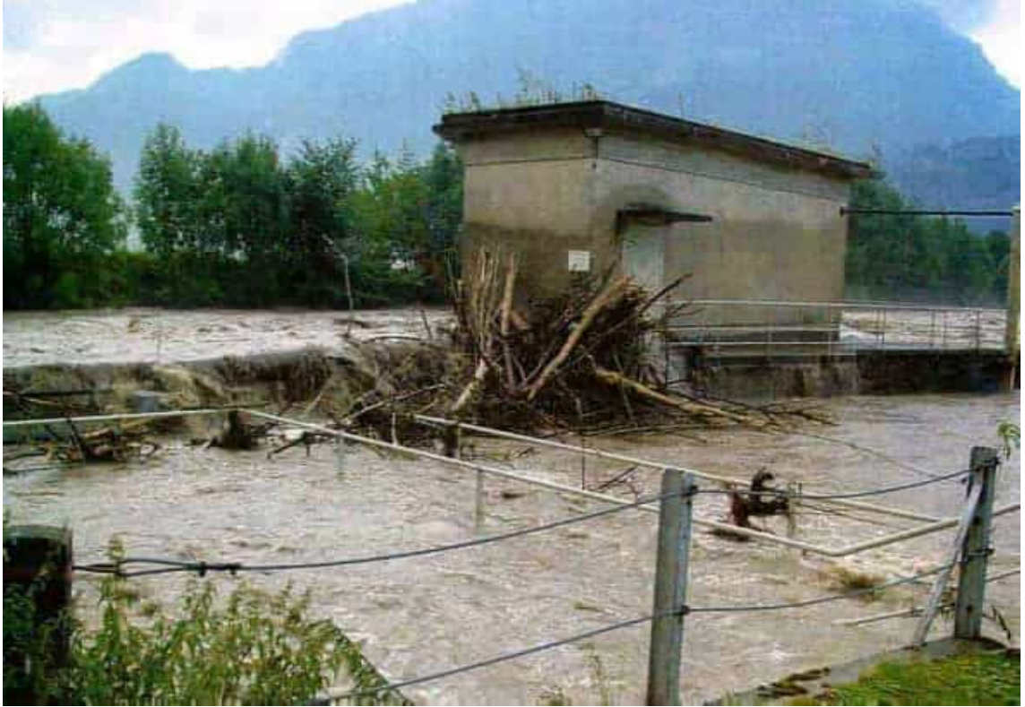
Abbildung 3: Schwemmholtansammlung am Technikgebäude beim Einlauf Oberwasserkanal, Ereignis 23.08.2005, Quelle: Fotoalbum Hochwasser August 2005, Holcim Schweiz AG
