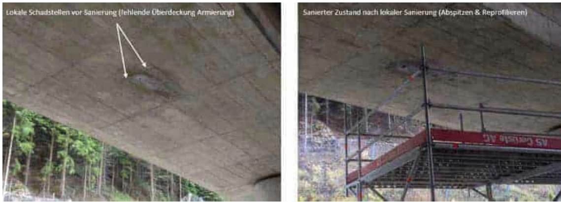
Abbildung 6.3: Beispielbilder Sanierung von lokalen Schadstellen an Tragwerkskonstruktionen, Projekt Instandsetzung Verladeanlage Goppenstein Teil 1+2, Foto: K+Z AG
