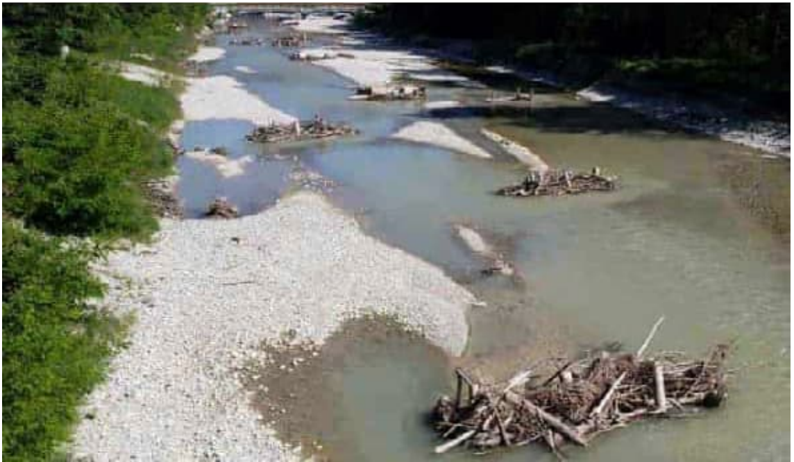
Abbildung 58: Beispielbild von eingebauten Totholzinseln an der Emme in Solothurn, Quelle: Projekt HWS Emme Solothurn, PG Bau
