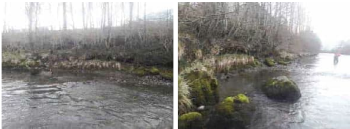
Abbildung 5: Kollabierter Blocksatz linksufrig ca. bei Gewiss-Adresse 2311
