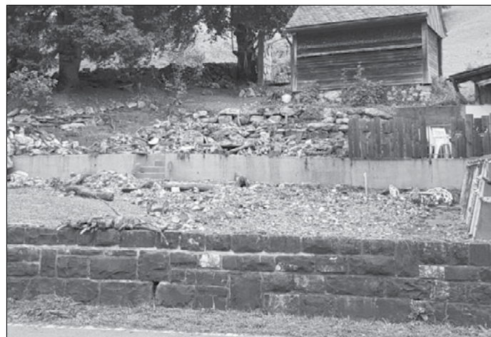
Abbildung 1: Übersarung und Geschiebeablagerung Hochwasser 2021, Geissbergbach oberhalb Dorfstrasse
