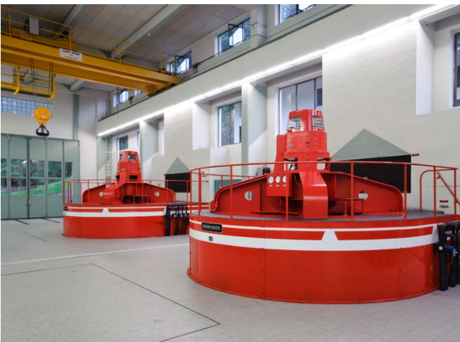
Bild: Zwei der drei Maschinen in der Zentrale Wernisberg
