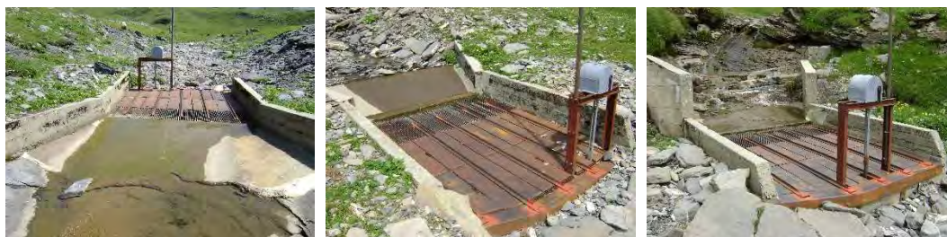
Abbildung 3-4 Bestehende Fassungen „vorderer Läckibach“, „Grossbodenbach“ und „Clubhüttenbach“ (von links, Fotos: ebs Energie AG).
