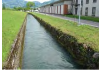
Abbildung 3: KW Ibach - UW-Kanal: offener Kanal
