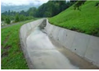
Abbildung 2: KW Ibach - OW-Kanal offener Kanal
