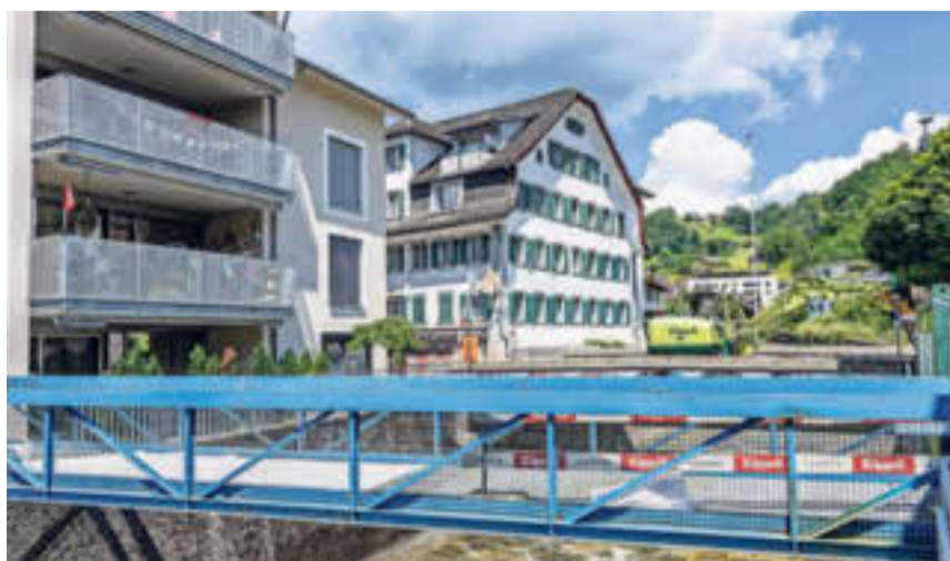
Im Hintergrund ist die Dorfbrücke, die bis Ende Monat saniert wird. Sie bleibt komplett gesperrt. Vorne ist die blaue Ersatzbrücke für Fussgänger. Bild: Erhard Gick
