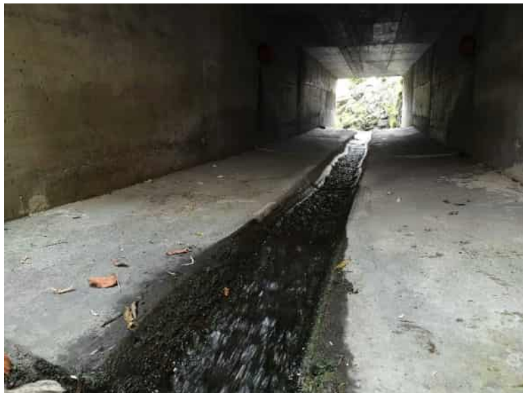
Abbildung 6: Durchlass Luzernerstrasse (Blickrichtung Bachaufwärts)
