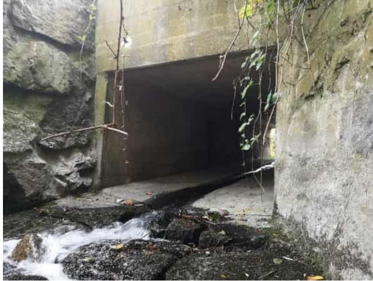
Abbildung 5: Durchlass Luzernerstrasse (Blickrichtung Bachaufwärts)
