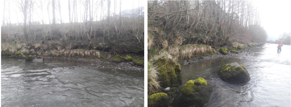
Abbildung 4: Kollabierter Blocksatz linksufrig ca. bei Gewiss-Adresse 2311
