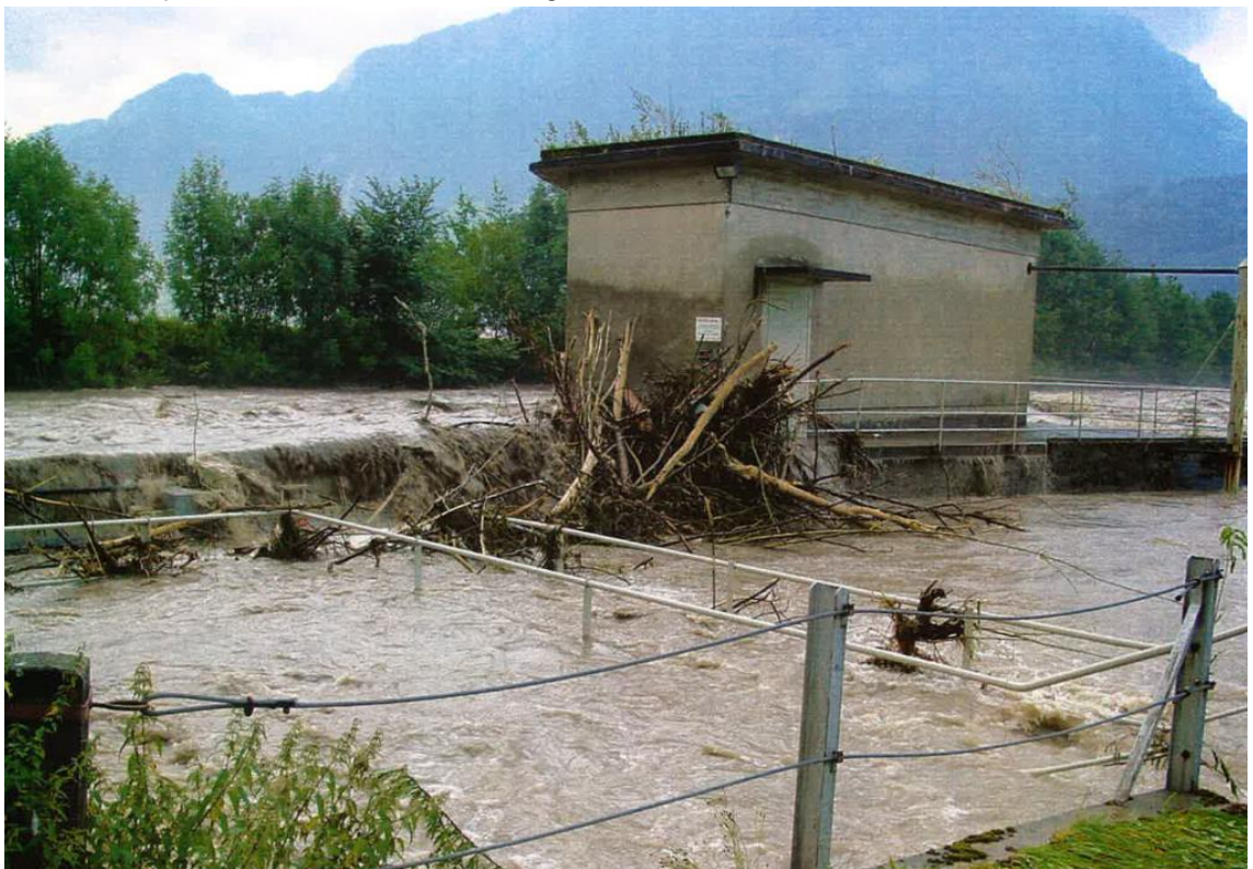
Abbildung 2: Schwemmholzansammlung am Technikgebäude beim Einlauf Oberwasserkanal, Ereignis 23.08.2005, Quelle: Fotoalbum Hochwasser August 2005, Holcim Schweiz AG
