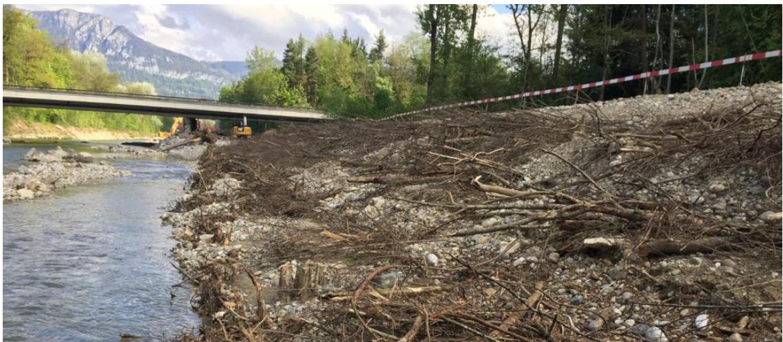
Abbildung 41: Blocksatz mit vorgelagerter BMU direkt nach dem Einbau, Foto: Projekt HWS Emme Solothurn, PG Bau
