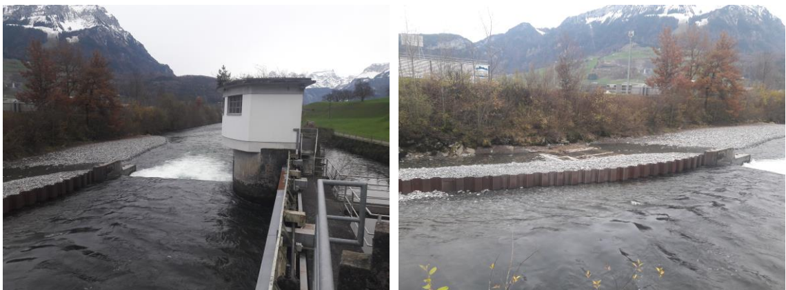
Abbildung 5: Wanderhindernis Wehr KW Brunnen mit einer Spundwandabtrennung zwischen dem Wehr und dem Umgehungsgerinne, Fotos: K+Z AG
