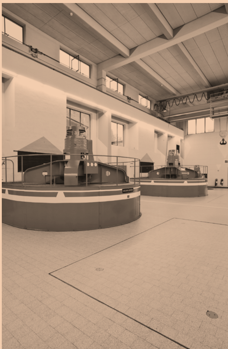
Der Maschinensaal des Kraftwerks Wernisberg.
