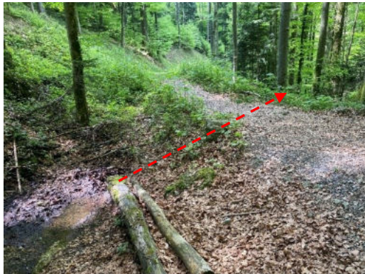
Verstopfter Durchlass Forstweg (roter Pfeil)
