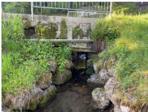
Schadhafter Strassendurchlass/ Brücke
