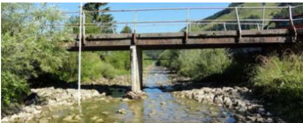
Brücke Oberstuden mit Verklausungsrisiko
