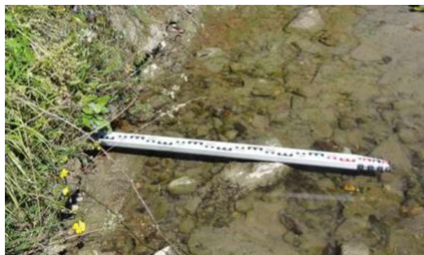
Auskolkungen in den Ufermauern
