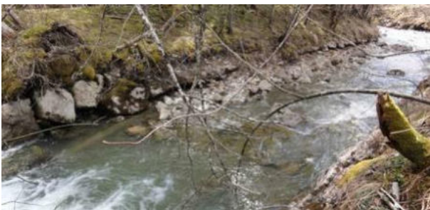
unterkolkte Ufer; Blocksteine abgeschwemmt
