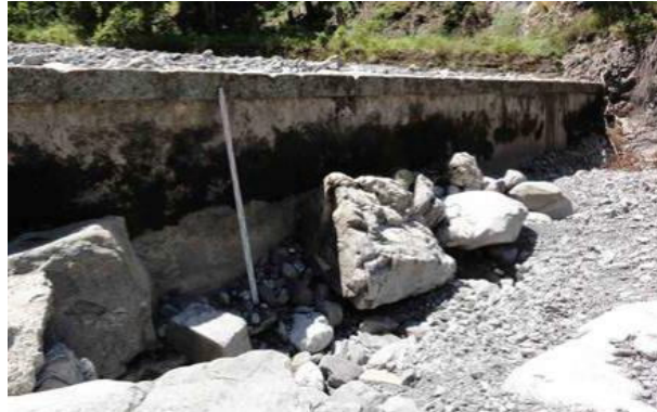
Schwelle unterkolt und fehlender Sperrenflügel
