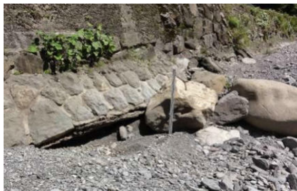
lokale Unterkolkung der Ufermauer
